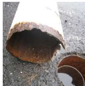
ポール看板の倒壊
