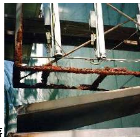
袖看板の底部脱落
