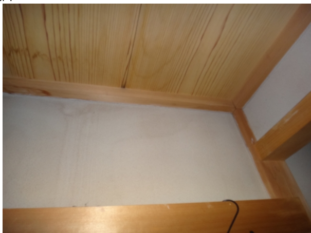
天井 > 仕上げ材表面 > 壁紙等 > 水染み跡
