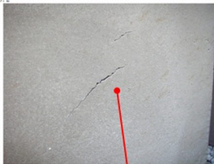
基礎 > 基礎表面 > モルタル仕上げ > 浮き
